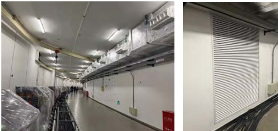
图 5.2-30 隧道排风口(左)隧道进风口(右)
