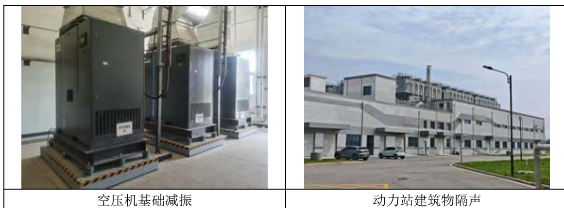
图 6.1-4 噪声治理措施现场照片
