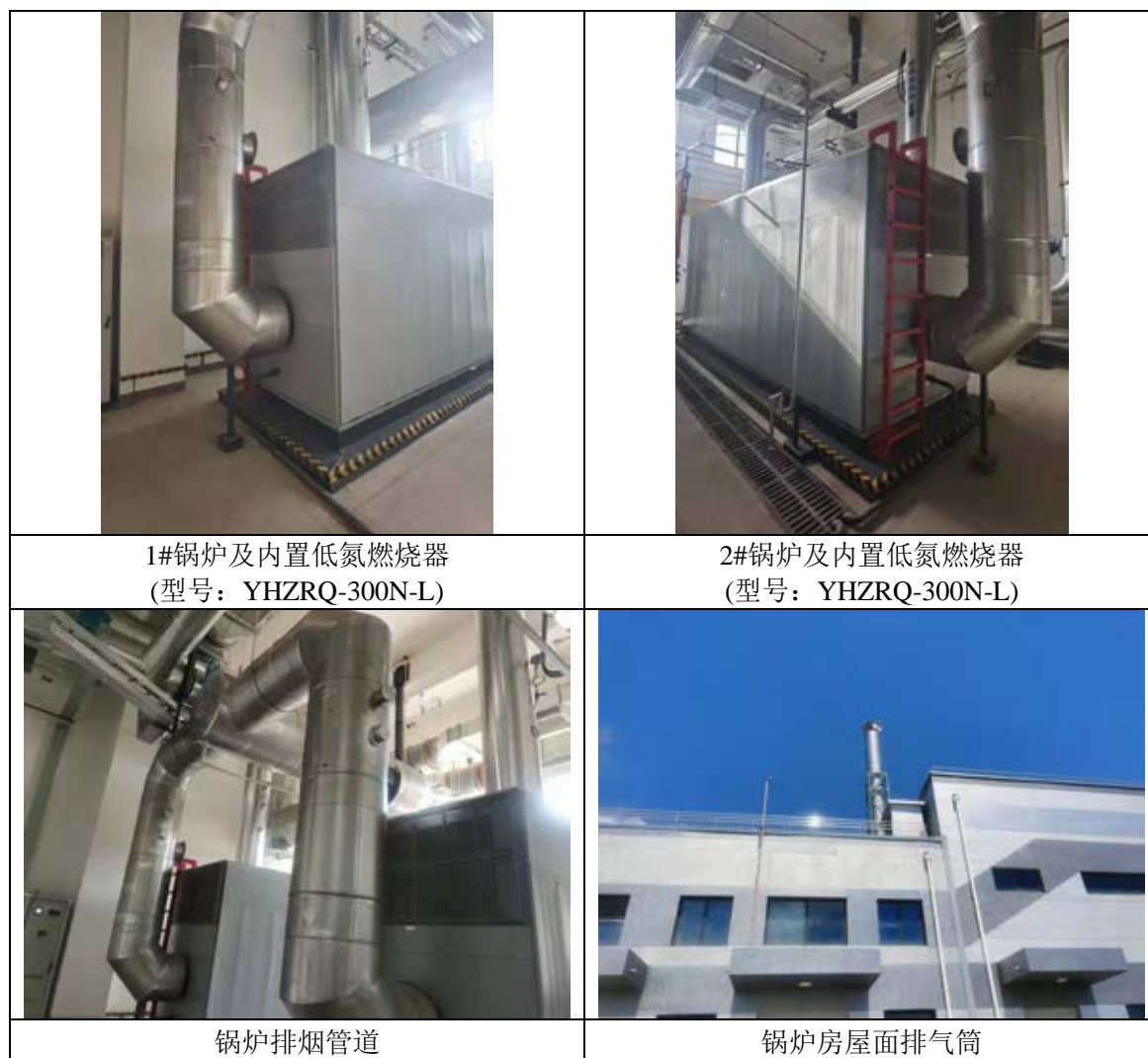
图 6.1-1 锅炉及低氮燃烧器
